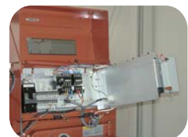
制御盤内後面
