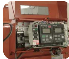
制御盤内前面
