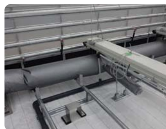
排ガスを利用したCO 2 施用
