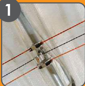
天井滑車付近の 隙間
