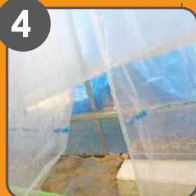
妻面カーテンの 隙間
