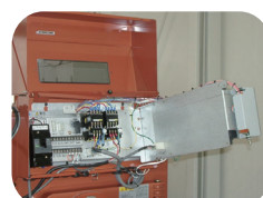
制御盤内後面
