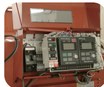
制御盤内前面
